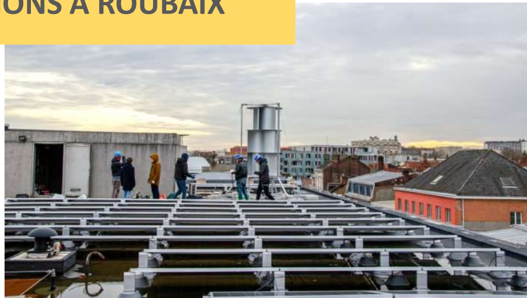
Sur la médiathèque une installation photovoltaïque associée à une éolienne urbaine en autoconsommation
